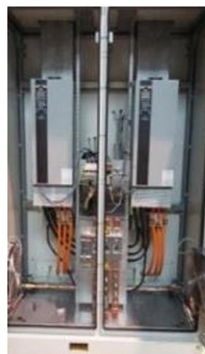
Convertisseurs de fréquence entraînements de compresseur + raccordement à l'alimentation secteur
